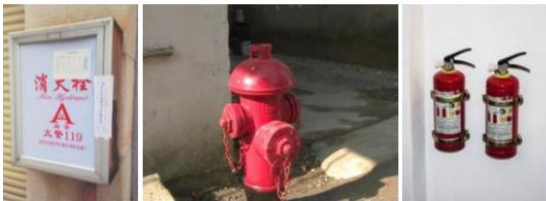
图 5.1-41 楼栋消防设施
