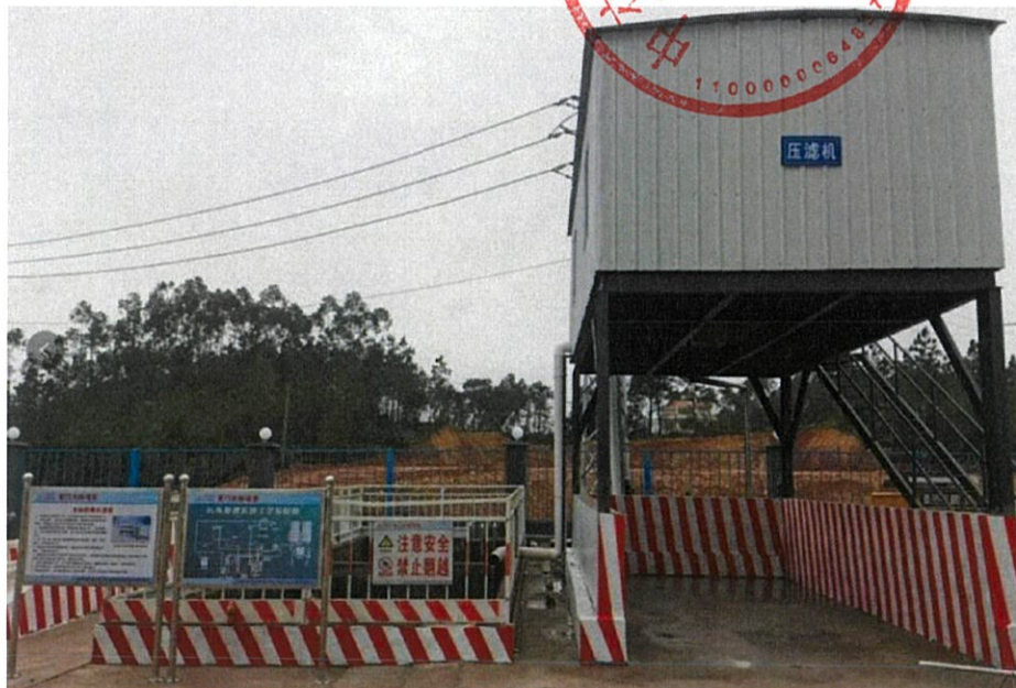
图 1.4.2-20 污水处理系统压滤机
