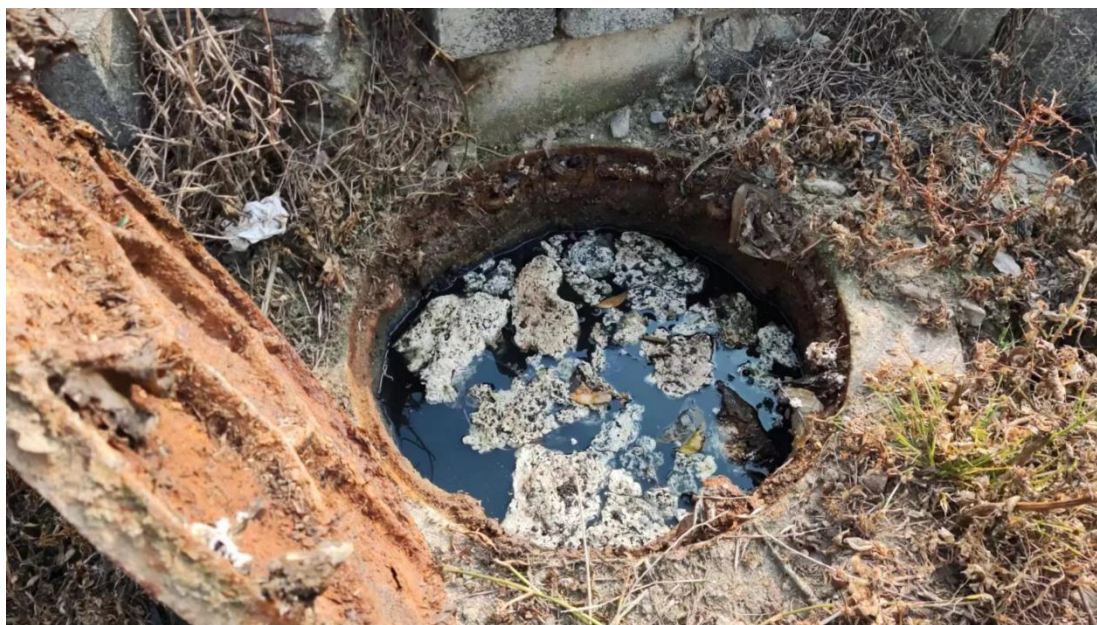
图 3-6 排污现状图（沟渠堵塞、黑臭水体现象）
