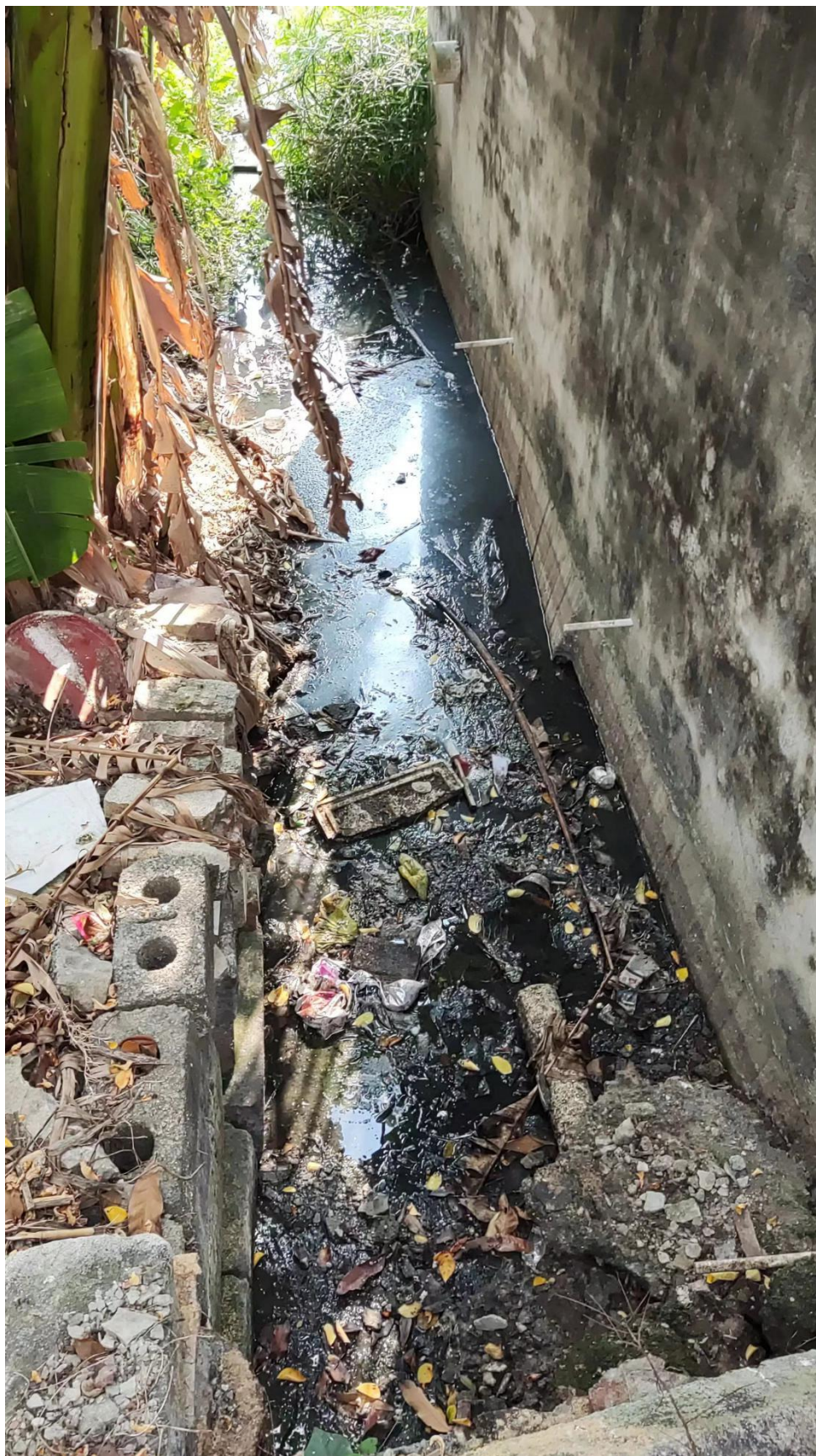
图 3-3 排污现状图（沟渠堵塞、黑臭水体现象）
