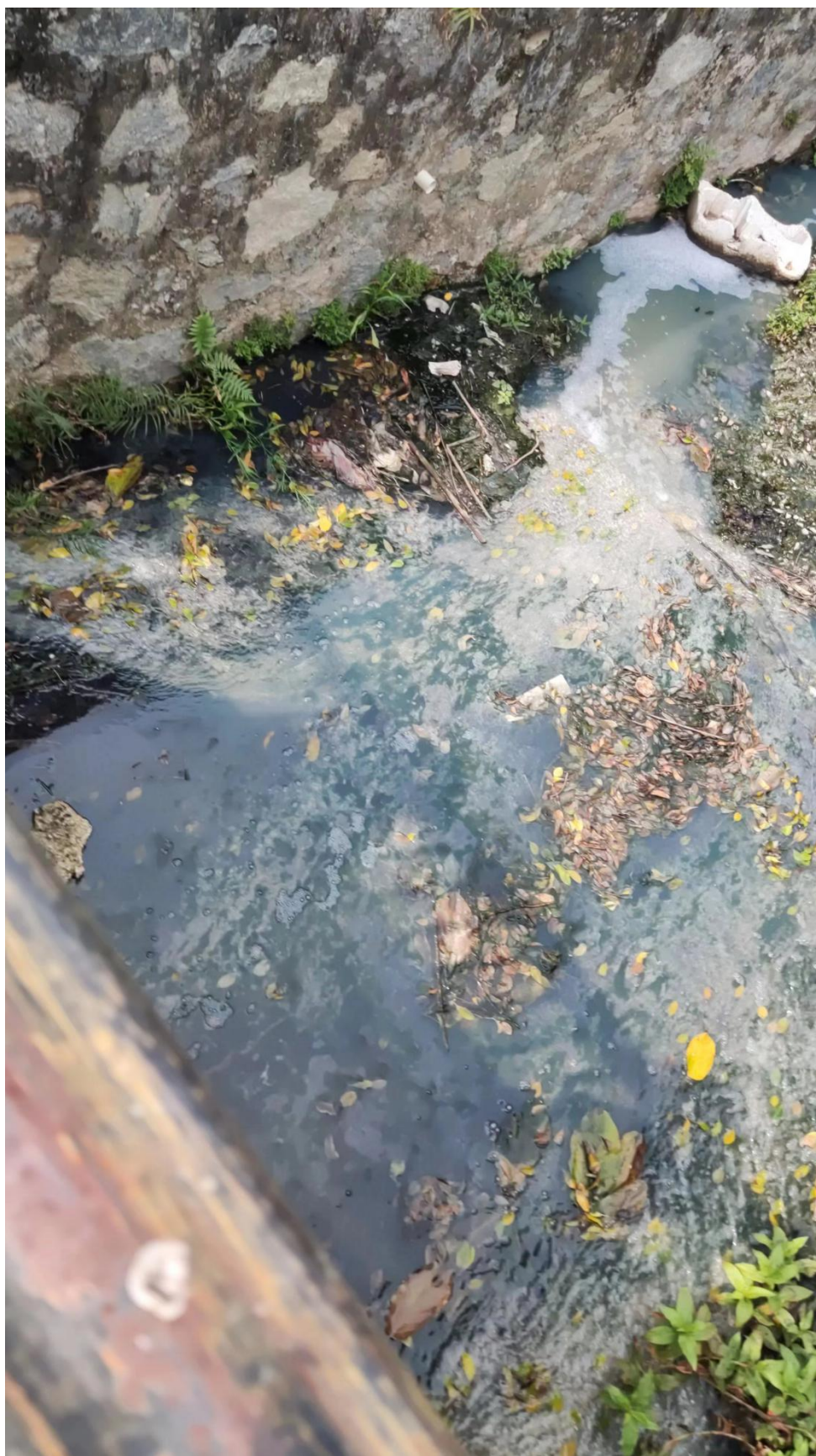
图 3-4 排污现状图（沟渠堵塞、黑臭水体现象）
