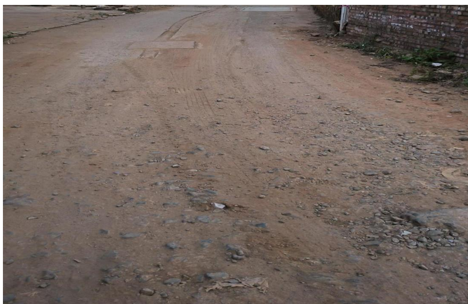
图3-3 部分水泥路面破损现状图
