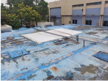
箱体顶板破损并进行修补
