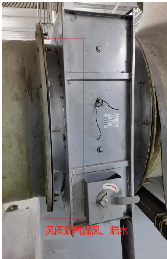
风阀漏气漏风、漏水
