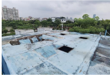
箱体顶板破损
