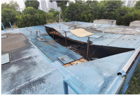
箱体顶板破损塌陷
