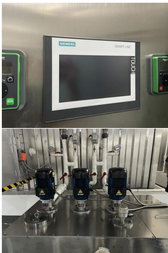
部分损坏设备现场照片
