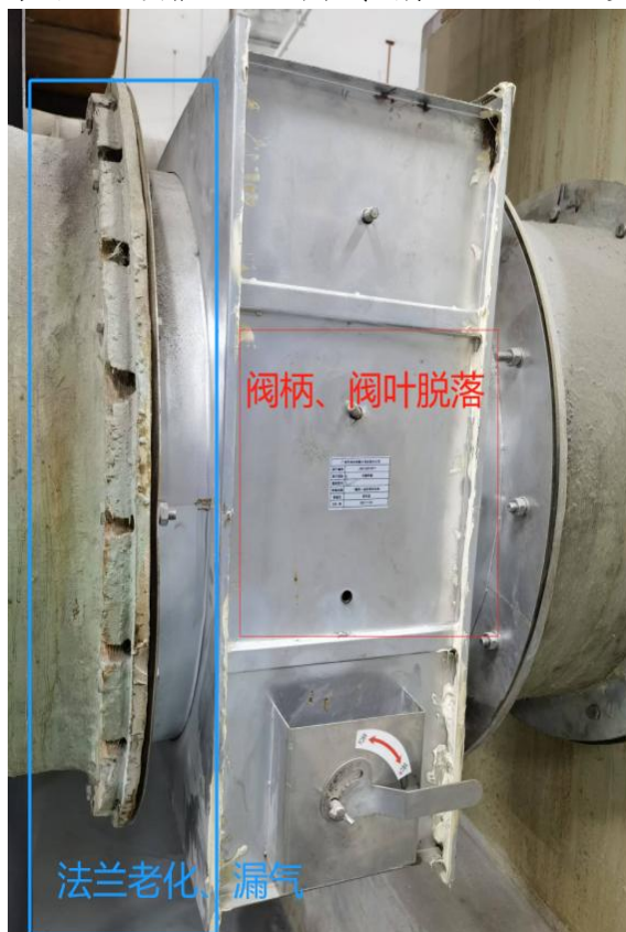
法兰老化、漏气，风阀阀柄阀叶松落
