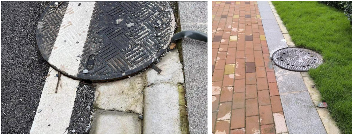
检查井盖不平整
