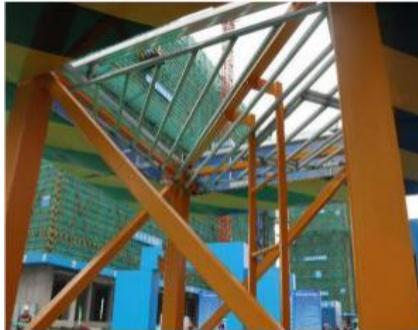
定型化塔吊防攀爬装置1
