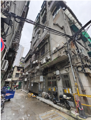
未建独立雨水立管
