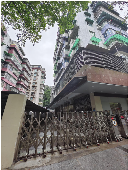
未建独立雨水立管
