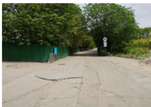
路面破损/板块破碎（雅瑶小学门口）
