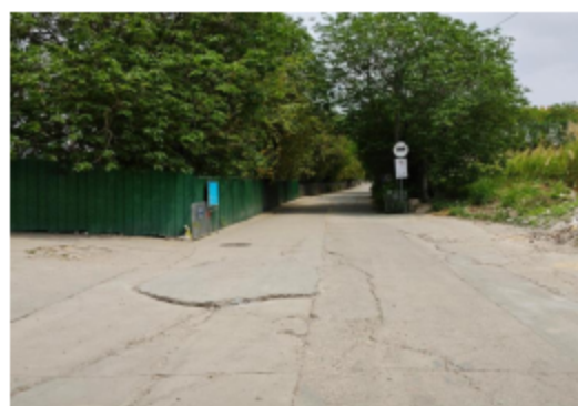
路面破损/板块破碎（雅瑶小学门口）
