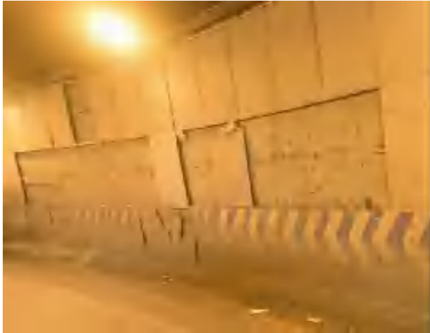
闭口段干挂板材装饰现状
