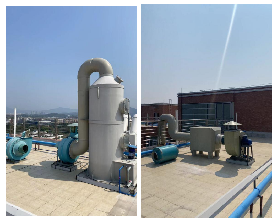
图3-28 废气治理设施
