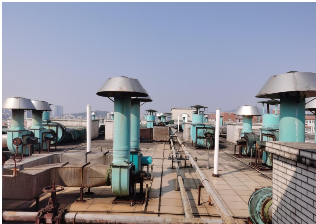
图3-26 顶层风机及排气筒
