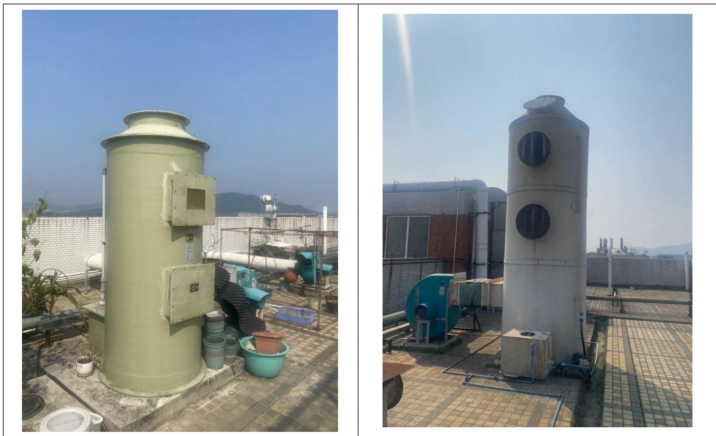
图3-30 废气治理设施
