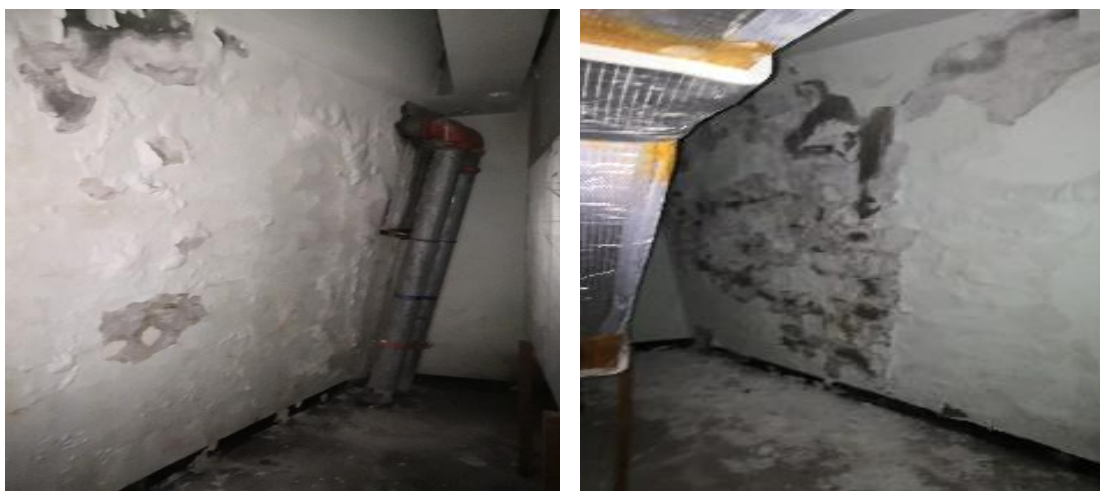
渗漏导致内墙面蜕皮脱落
