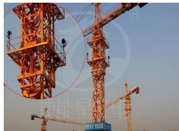
塔吊 LED 大灯实例
