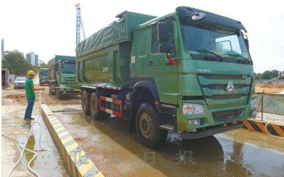
泥头车冲洗、遮盖、限载示例图
