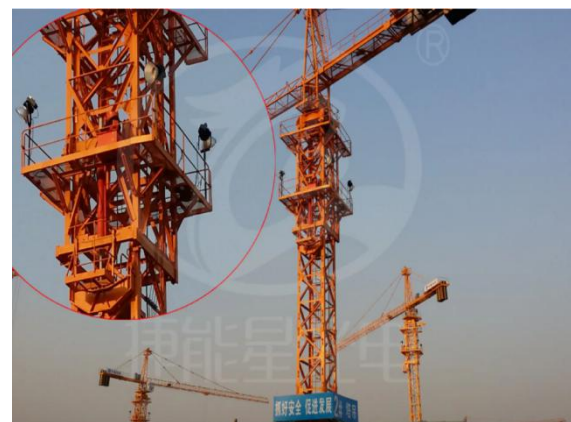
塔吊 LED 大灯实例
