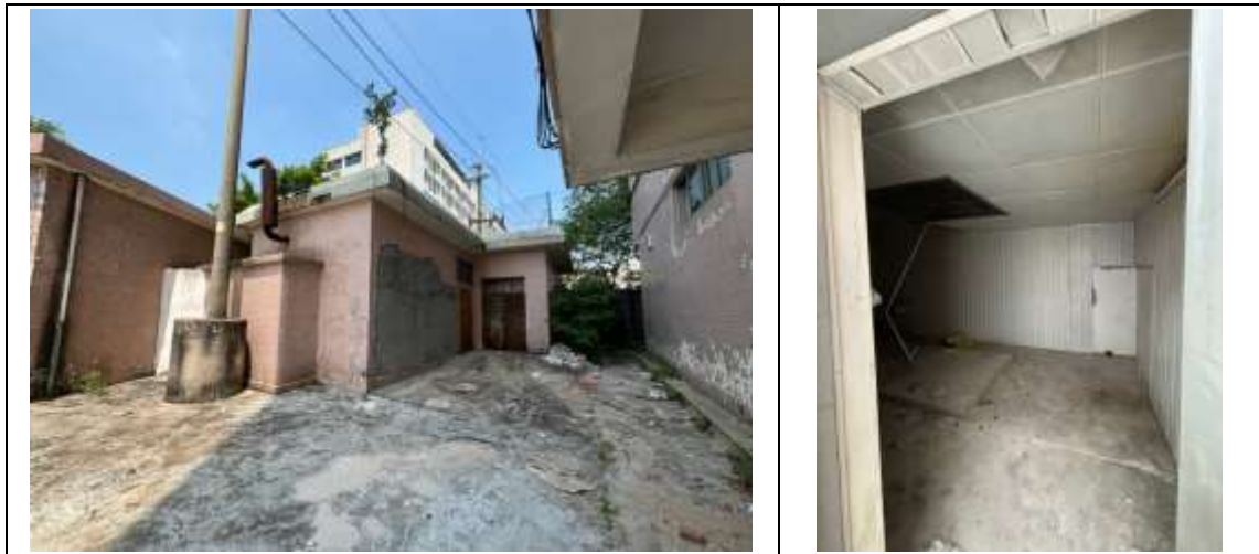
3.1-24 发电机房现状图片
