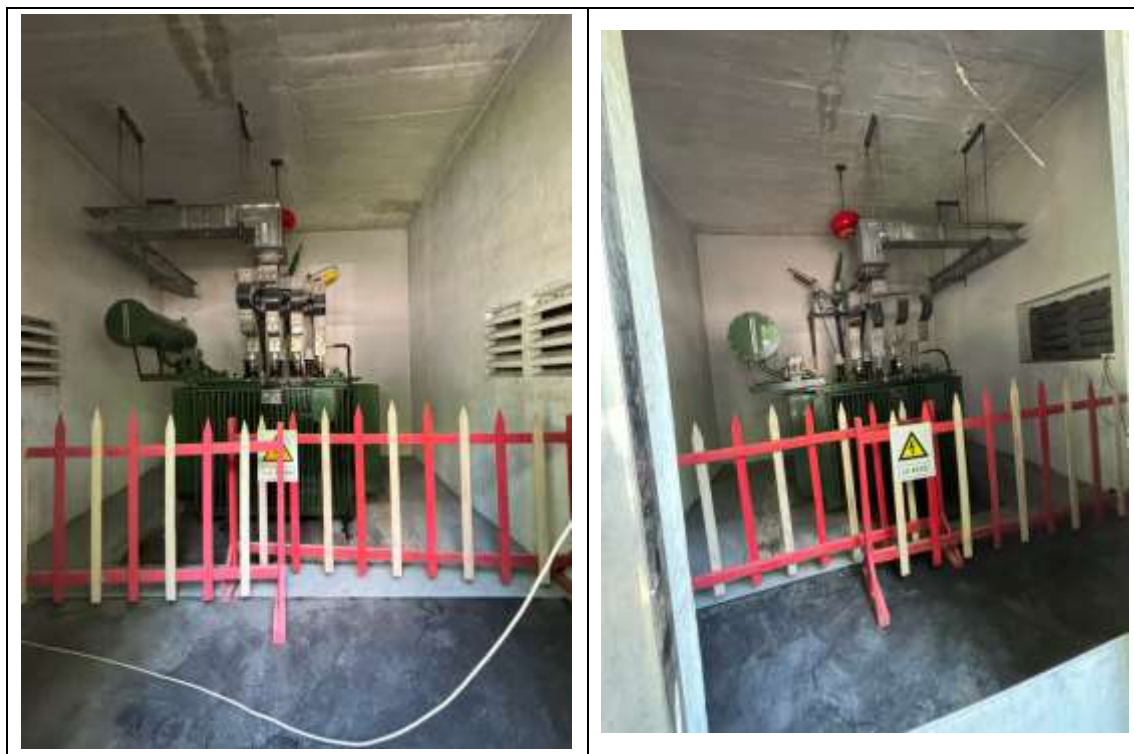
3.1-26 变电房现状图片
