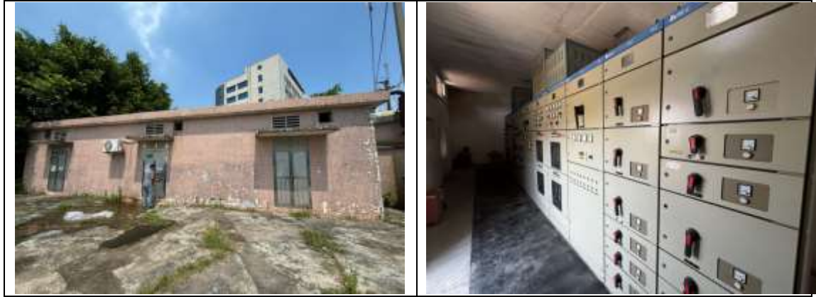
图 3.1-23 总电房现状图片
