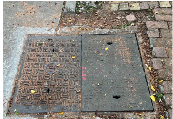
拟建道路终点处现状通信管线
