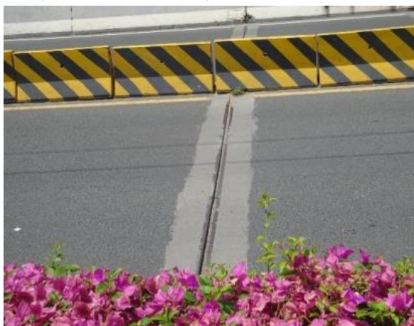
图 2.17 1#伸缩缝泥沙堵塞
