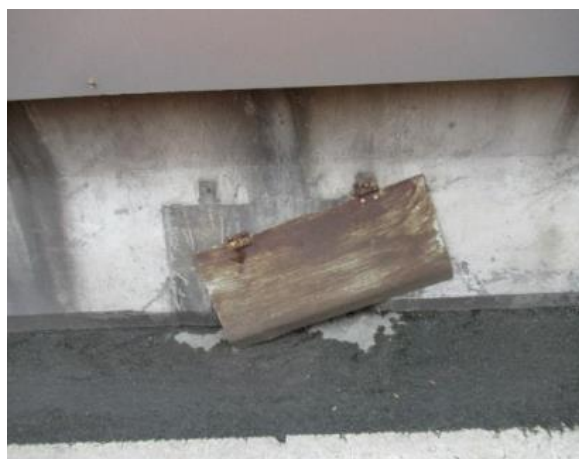
图 2.57 L15#跨泄水孔盖板脱落、堵塞
