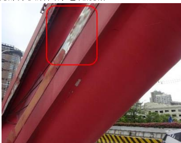
图 2.25 18#跨上游南侧拱肋面漆脱落
