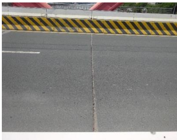
图 2.18 2#伸缩缝泥沙堵塞
