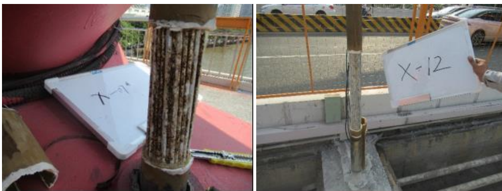
图 5.2 解放大桥吊杆锈蚀现状
