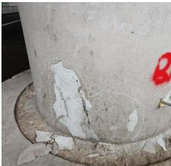
图 2.72 0#墩底部开裂破损
