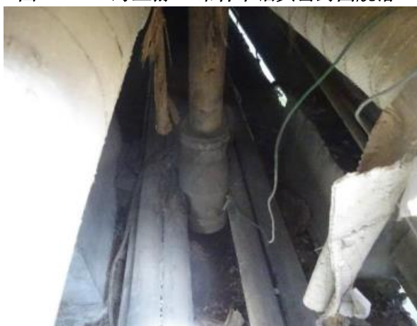
图 2.23 19#跨下游 7"#吊杆下锚头密封圈老化
