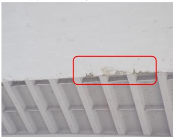
图 2.35 19#墩盖梁底部锈胀露筋
