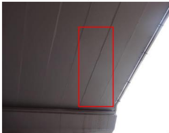
图 2.47 4#跨 4#板梁变色起皮
