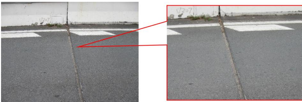
图 2.69 0#墩顶伸缩缝泥沙堵塞
