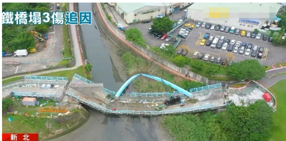
图 2.77 新北市观音坑溪桥断裂
