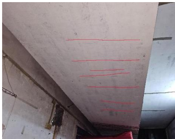
图 2.68 4#跨梁底板横向裂缝
