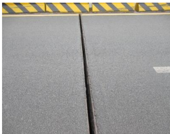
图 2.55 9#伸缩缝止水脱落
