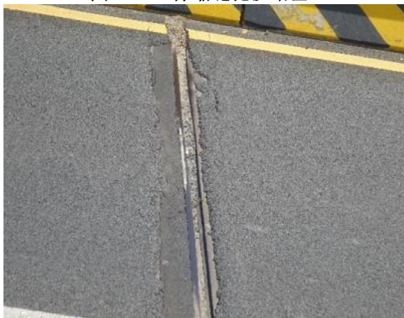
图 2.19 3#伸缩缝泥沙堵塞
