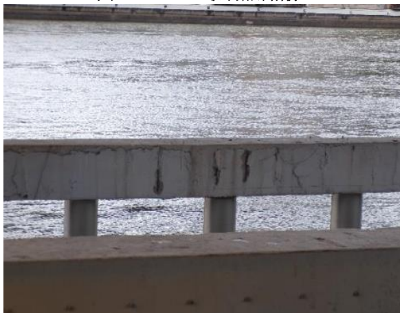
图 2.40 19#防护墩锈胀露筋
