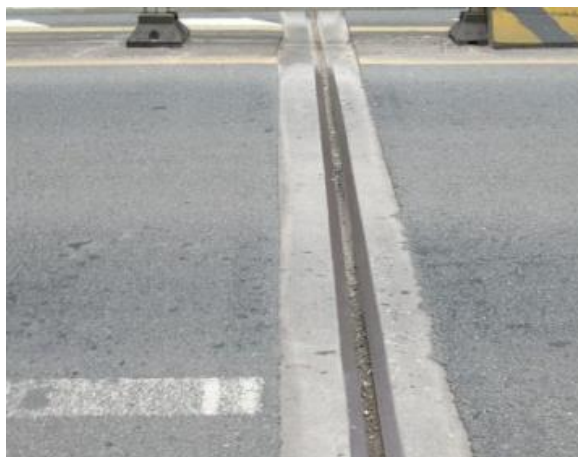
图 2.43 L9#伸缩缝泥沙堵塞
