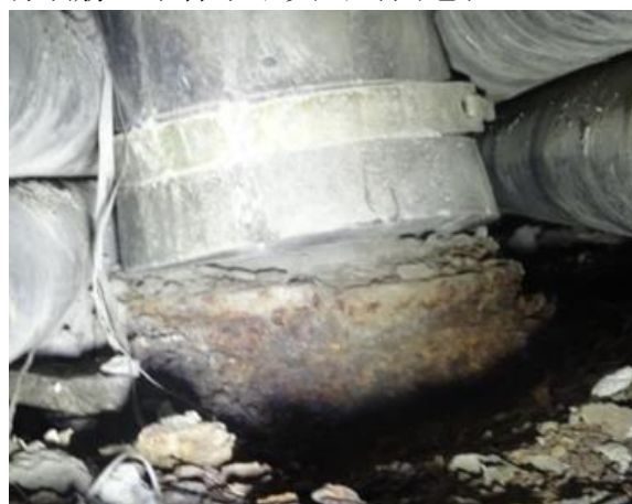
图 2.22 19#跨下游 6"#吊杆下导管严重锈蚀
