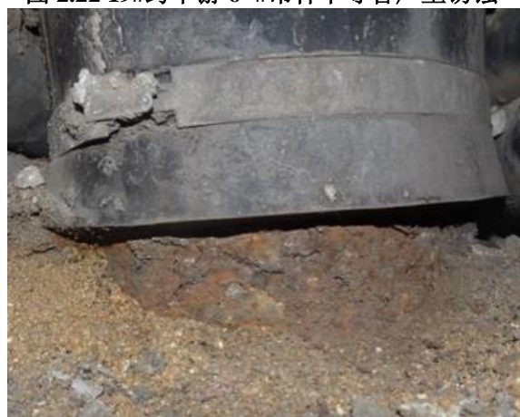
图 2.24 20#跨下游 16"#吊杆下导管严重锈蚀
