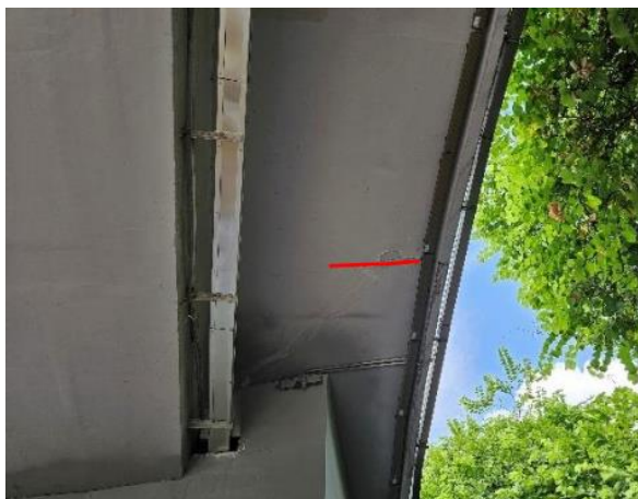
图 2.67 2#跨右翼板横向裂缝伴析白
