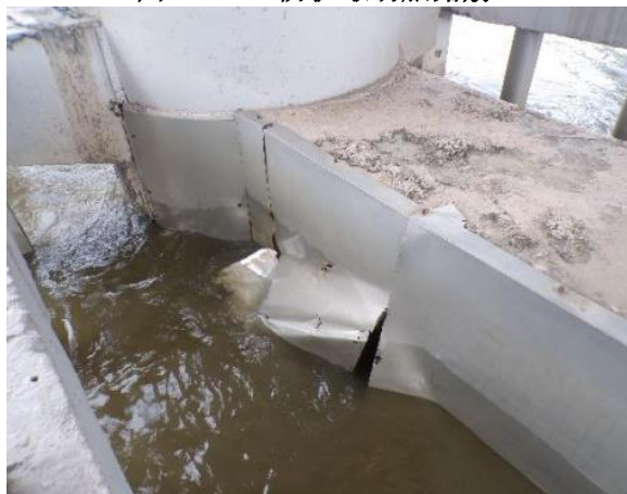
图 2.41 19#墩底部不锈钢薄板脱落
