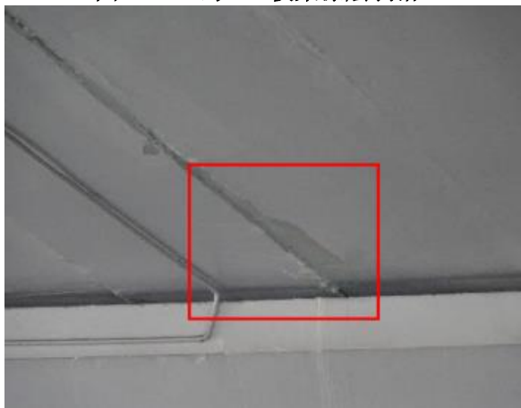
图 2.46 4#跨 18#板梁涂层剥落
