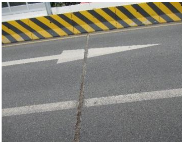
图 2.42 L1#伸缩缝泥沙堵塞
