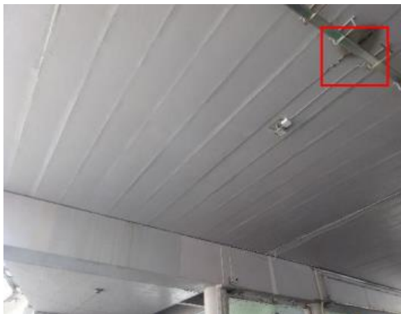
图 2.44 3#跨 26#板梁涂层剥落
