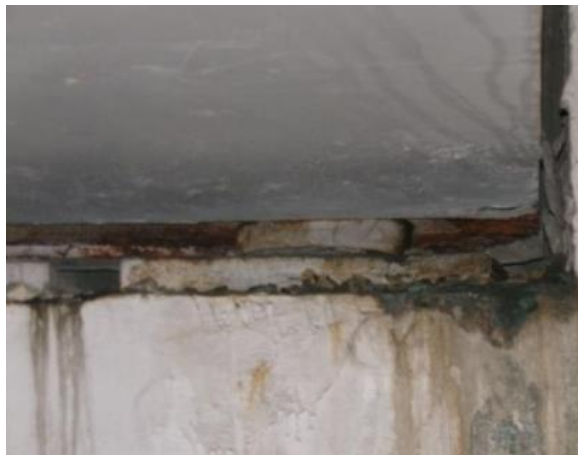
图 2.51 6-5-24#支座轻微老化开裂
