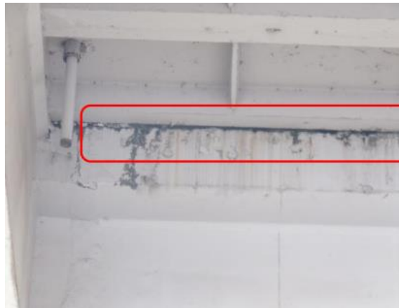
图 2.28 19#跨 1#主纵梁锈胀露筋
