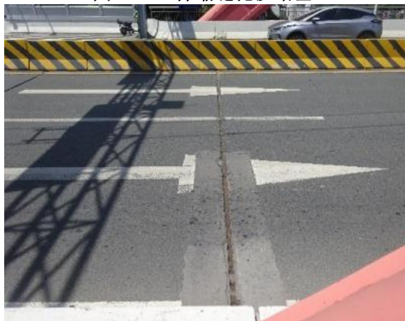
图 2.20 6#伸缩缝泥沙堵塞
