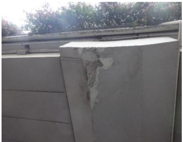
图 2.61 3#盖梁混凝土破损
