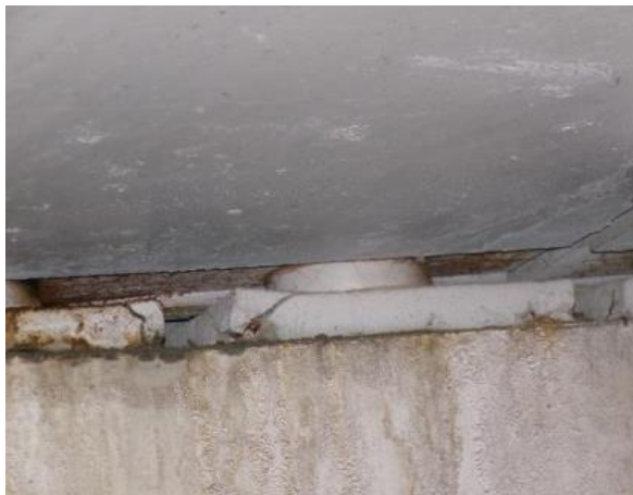
图 2.50 6-5-1#支座垫石破损
