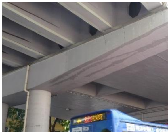
图 2.53 2#盖梁渗水痕迹
