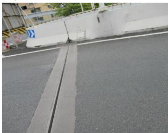
图 2.66 2#伸缩缝泥沙堵塞
