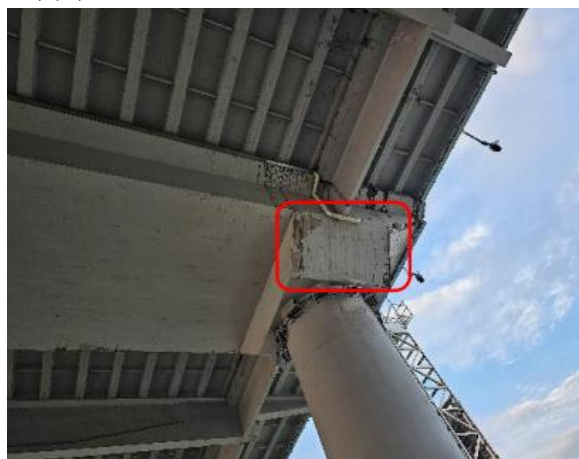
图 2.36 21-20#墩盖梁涂层剥落、开裂
