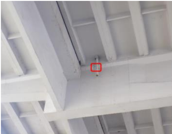
图 2.27 18#跨 2#主纵梁砼剥落
