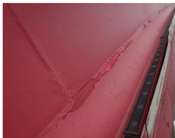
图 2.26 20#跨下游南侧拱肋涂层脱落
