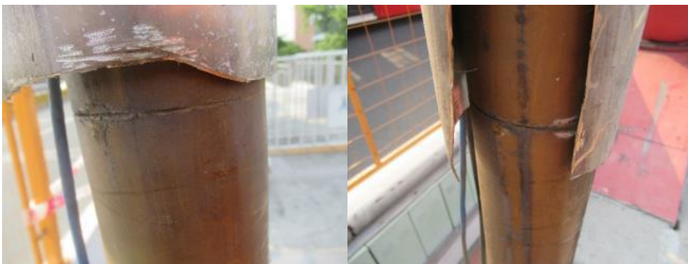
图 5.1 解放大桥吊杆护套刮伤现状
