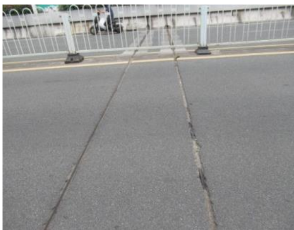
图 2.54 1#、2#伸缩缝锚固区咬边
