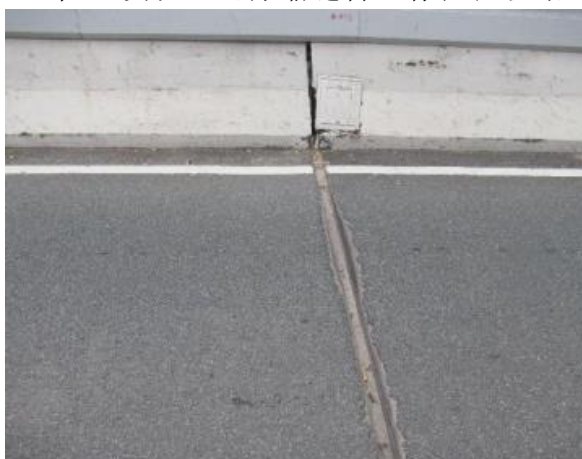
图 2.65 1#伸缩缝泥沙堵塞
