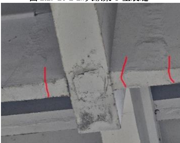
图 2.31 20-1-6#、7#大纵梁 U 型裂缝
