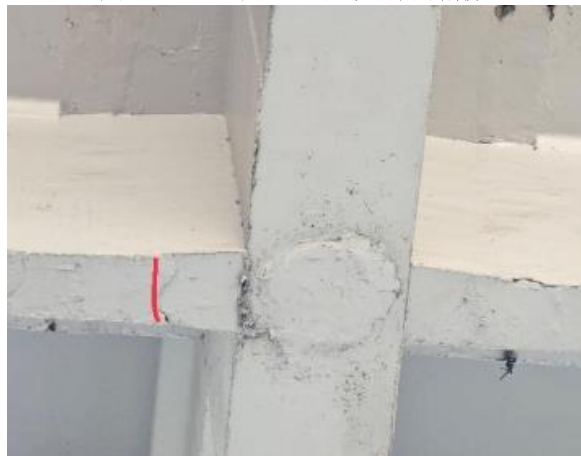
图 2.30 20-1-3#大纵梁底面横裂
