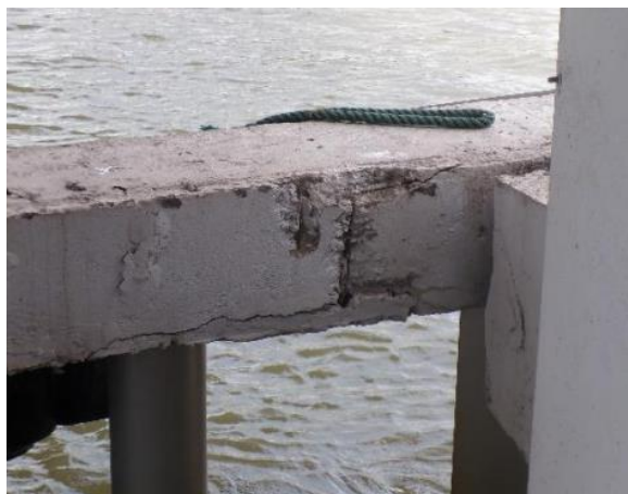
图 2.39 18#防护墩锈胀露筋
