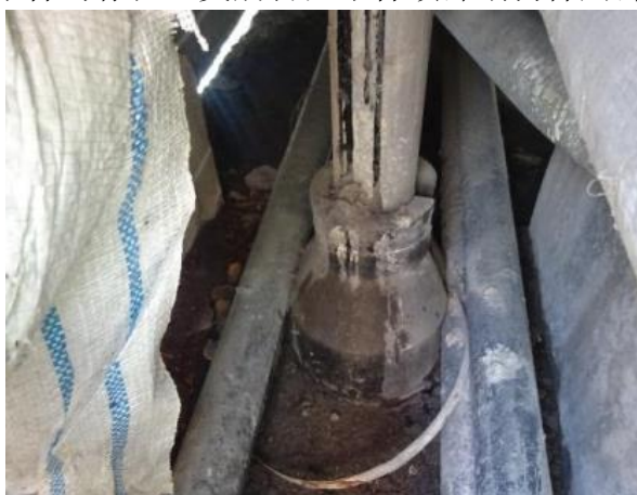
图 2.21 18#跨上游 8#吊杆下锚头密封圈脱落
