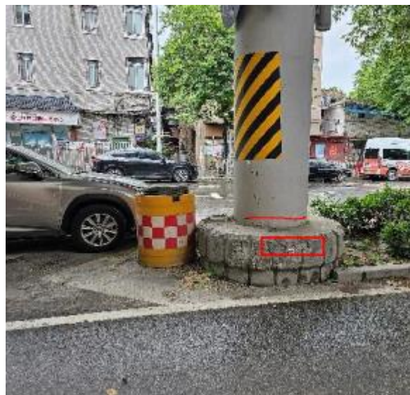
图 2.73 2#墩锈胀露筋、环裂
