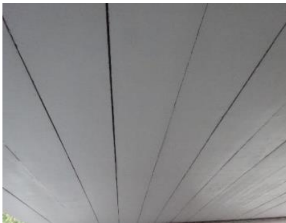
图 2.59 铰缝勾缝不饱满
