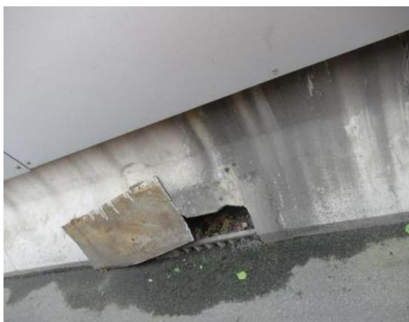
图 2.56 L8#跨泄水孔盖板脱落、堵塞上部结构
