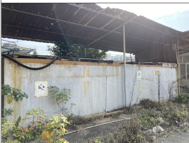
地上废水处理设备
