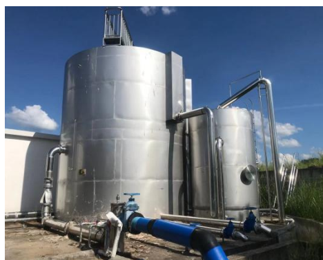
鸿鑫水厂一体化制水设备
